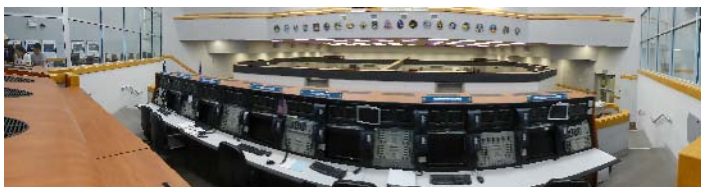
A l'intérieur du V.A.B: la salle de contrôle des lancements
